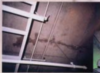
漏水する天井裏のクラック
