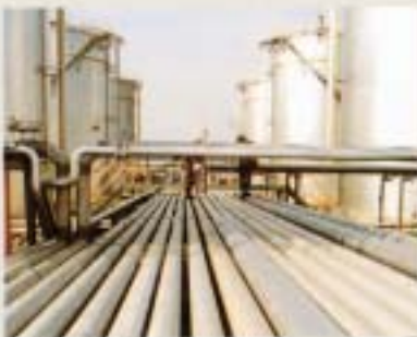
輸送配管・タンク
