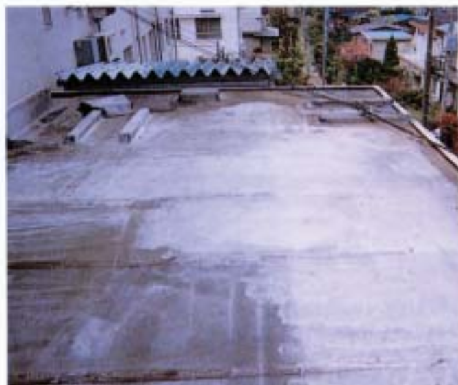
経年したアスファルト防水層
